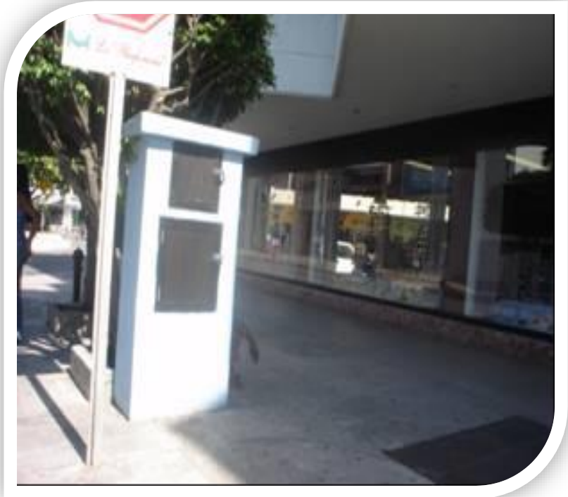
Subestación Av. Las Américas diagonal Cañón de Morgan
