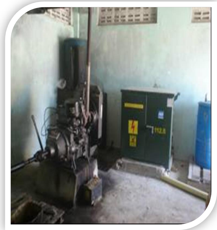
Subestación Swamp Ground
