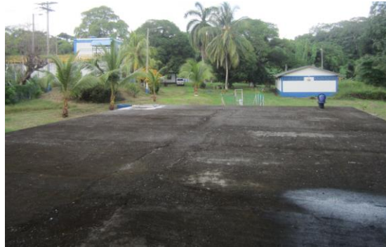
Tanque Almacenamiento agua tratada Duppy Gully
