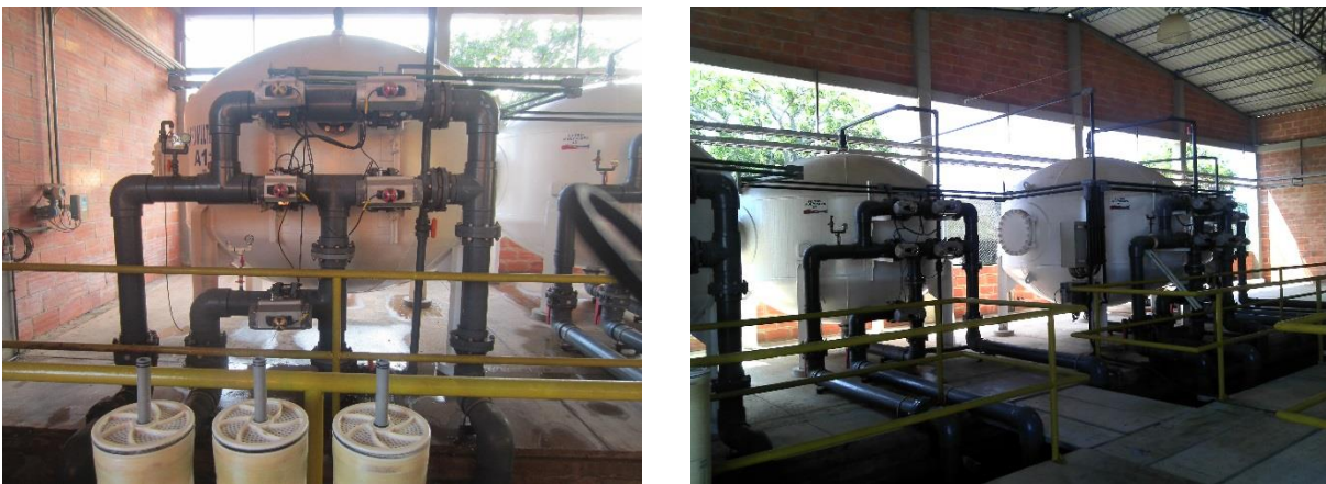
Foto 7-15 Sistema de filtración multimedia
