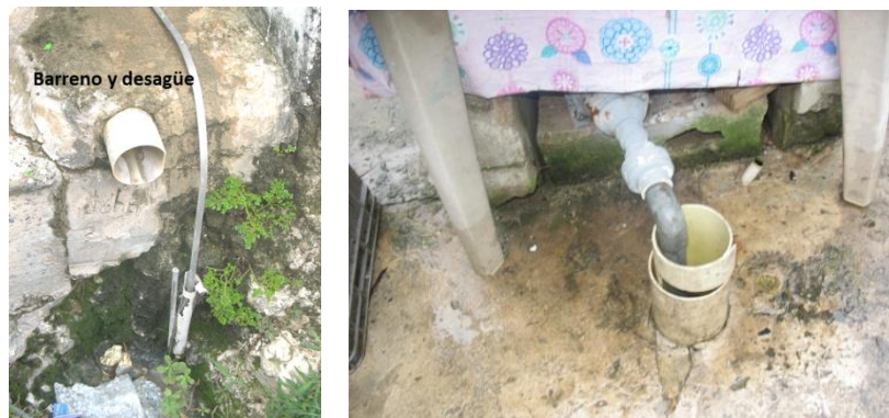
Foto 4-2 Pozos y desagües, instalaciones típicas en San Andres
