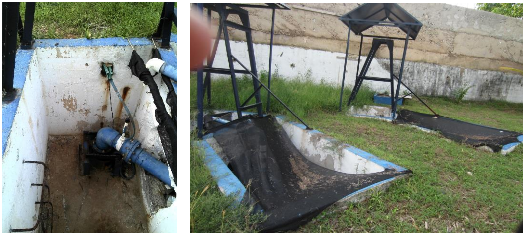
Foto 7-14 Pozos de abastecimiento desaladora
