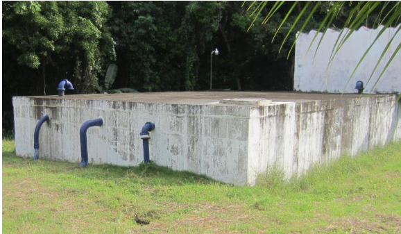
Tanque Almacenamiento agua tratada Duppy Gully
