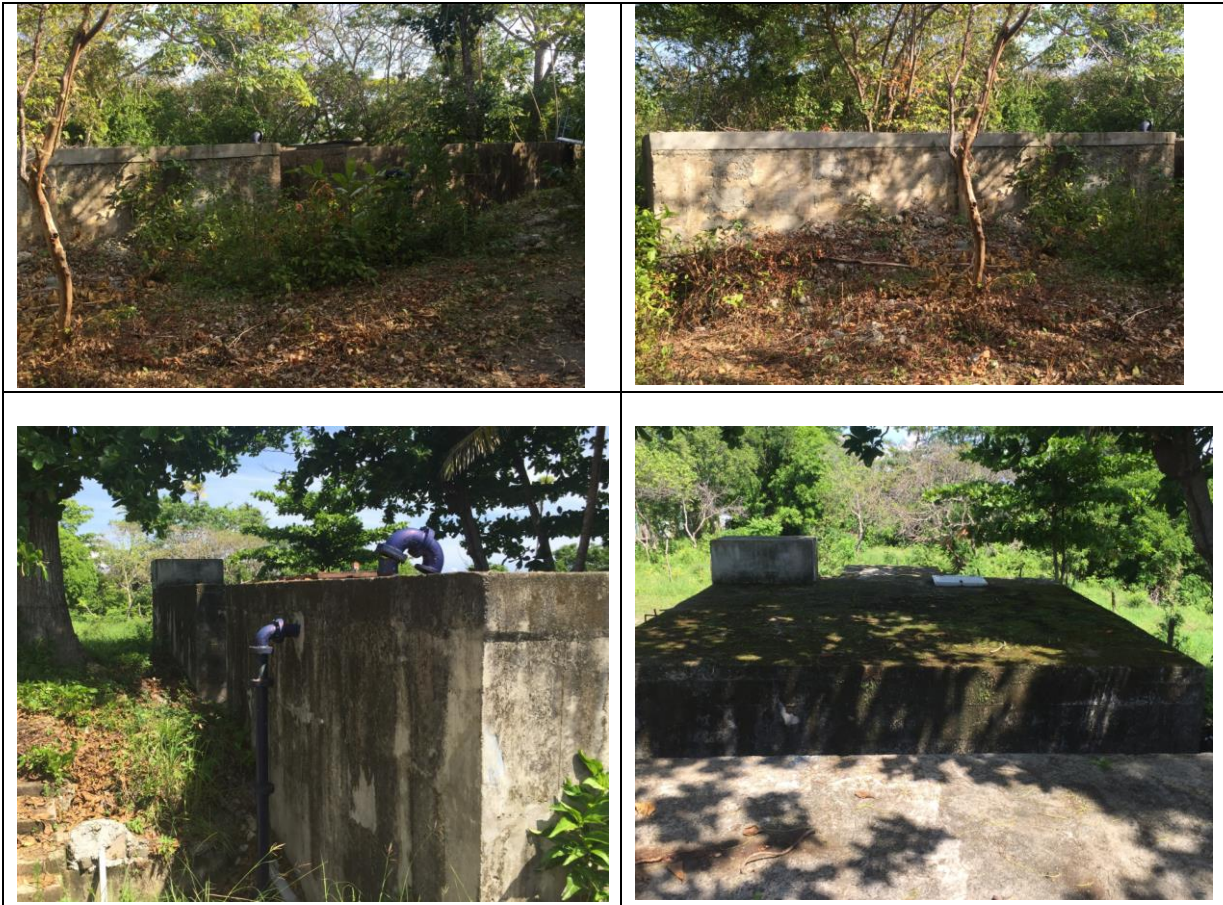
Foto 8-13 Tanque San Luis y Tanque El Cove
