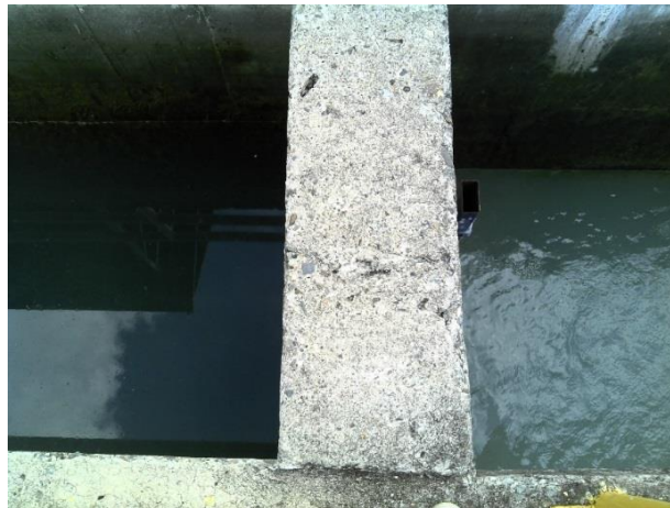
Foto 7-12 Izquierda: Filtro sin lavar (terminando carrera), Derecha: filtro recién lavado (iniciando carrera)
