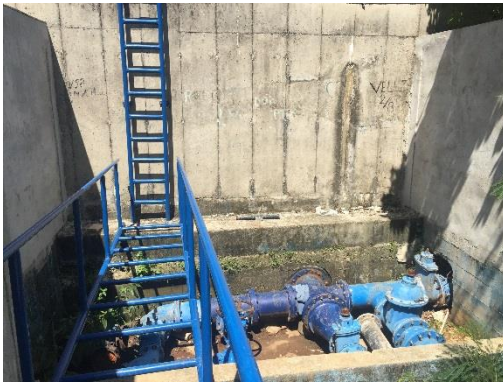
Foto 8-7 Caja de válvulas a la salida de los tanques del Cliff
