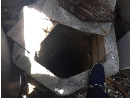
Pozo para extracción de agua subterránea
