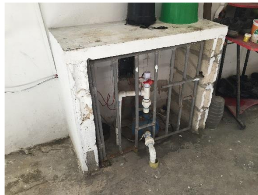
Sistema de bombeo a partir de la cisterna
