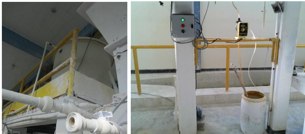
Foto 7-7 Tanque preparación sulfato de aluminio, dosificador.
