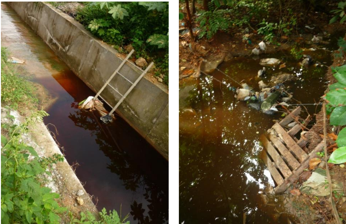
Foto 11-15. Contaminación por lixiviados de un Gully.
