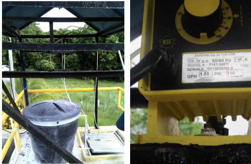
Foto 7-13 Caseta de cloración, detalle bomba dosificadora
