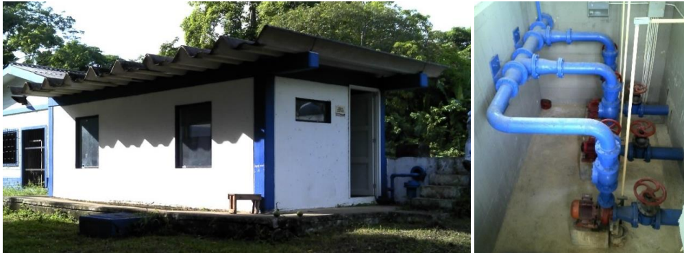
Foto 7-4 Caseta de Bombeo agua cruda, estación de bombeo
