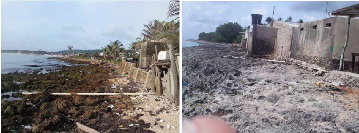
Foto 9-40 Descarga de aguas domesticas procedentes de pozos sépticos
