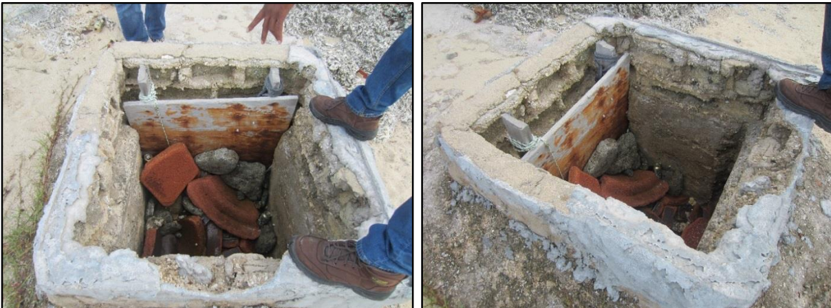
Foto 9-45 Compuerta de control. Tubería de descarga al mar
