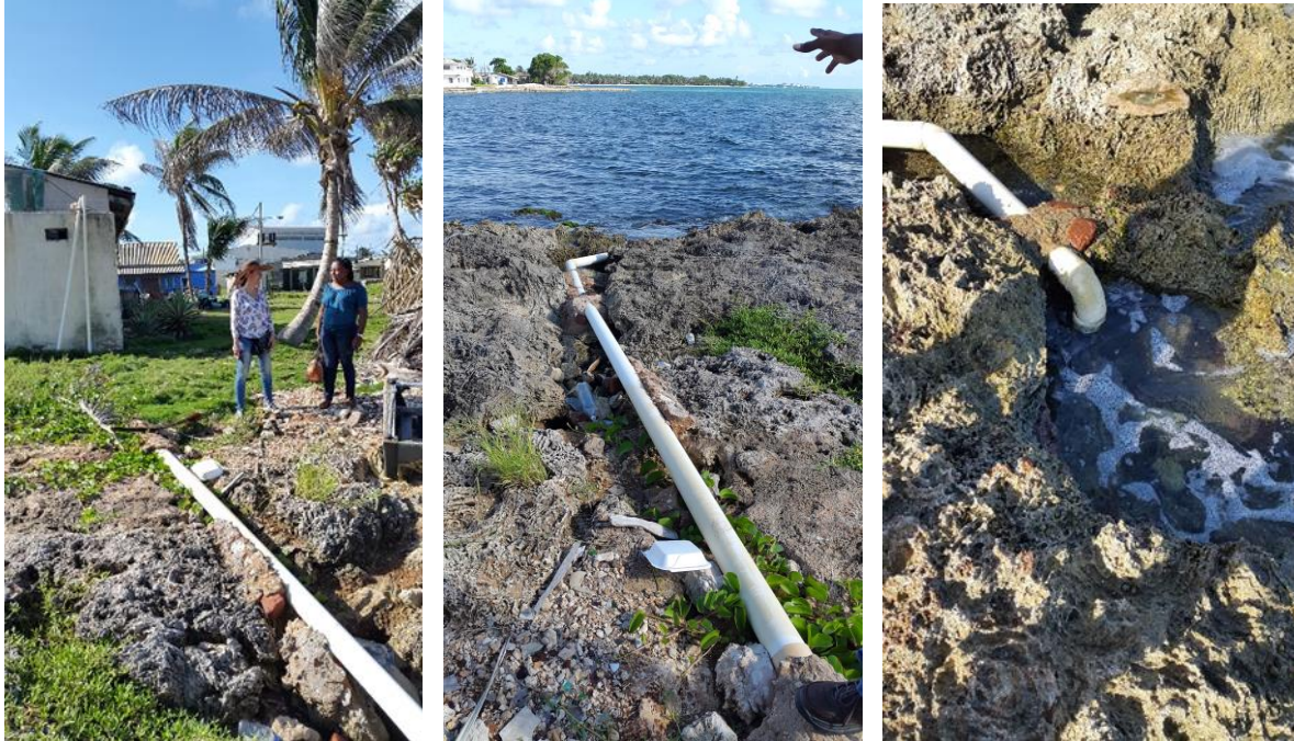
Foto 9-43 Tubería de descarga al mar
