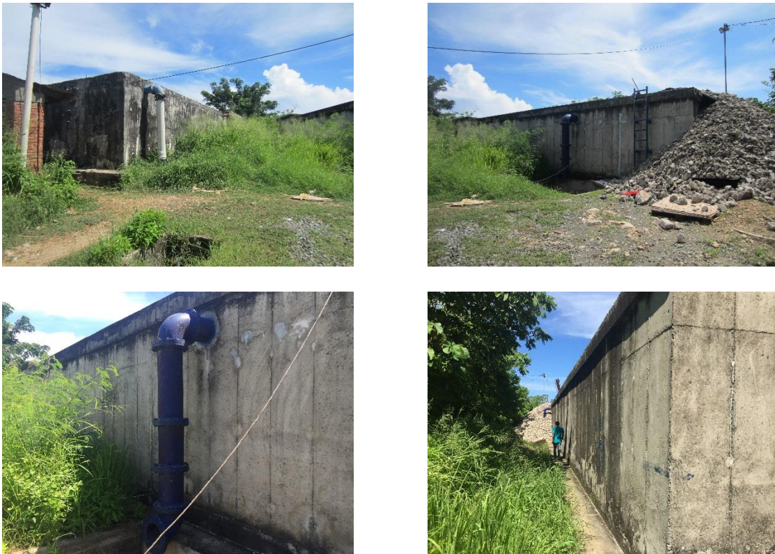
Foto 8-6 Tanques de Almacenamiento del Cliff
