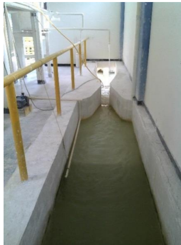
Foto 7-5 Canal de Ingreso y canaleta Parshall para aplicación de químicos
