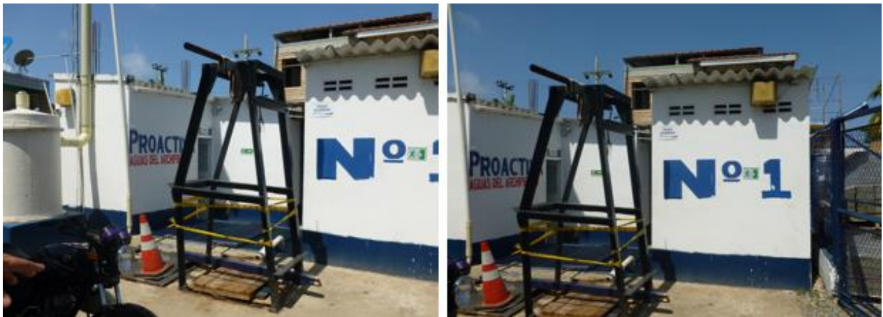
Foto 9-13 Soporte para izar o mover las bombas. Estación de bombeo 1
