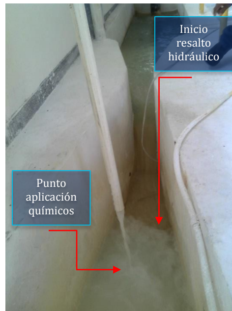
Foto 7-8 Punto aplicación de químicos, planta Duppy Gully
