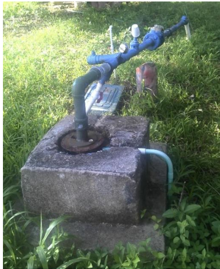
Foto 7-1 Pozo Pz6 ubicado en los precios de la planta Duppy Gully
