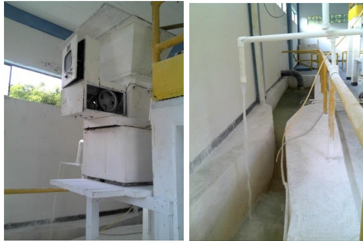
Foto 7-6 Tolva para preparación de CAL, punto de aplicación de CAL en la canaleta Parshall.
