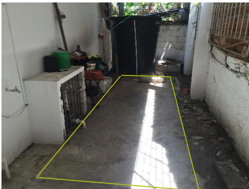
Cisterna de almacenamiento
