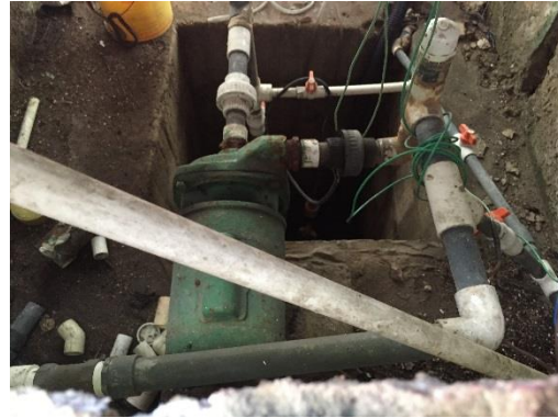
Sistema de bombeo para extracción de agua subterránea
