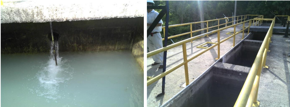
Foto 7-11 Ingreso de agua a unidad de filtración, batería de filtros.
