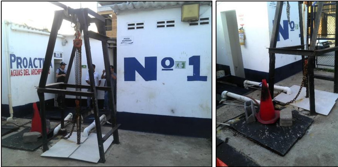
Foto 9-3 Pozo húmedo Estación de Bombeo No 1
