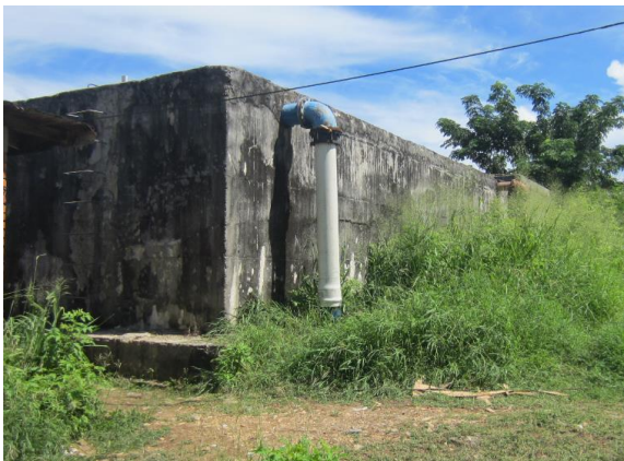
Foto 8-11 Tanques de almacenamiento del Cliff
