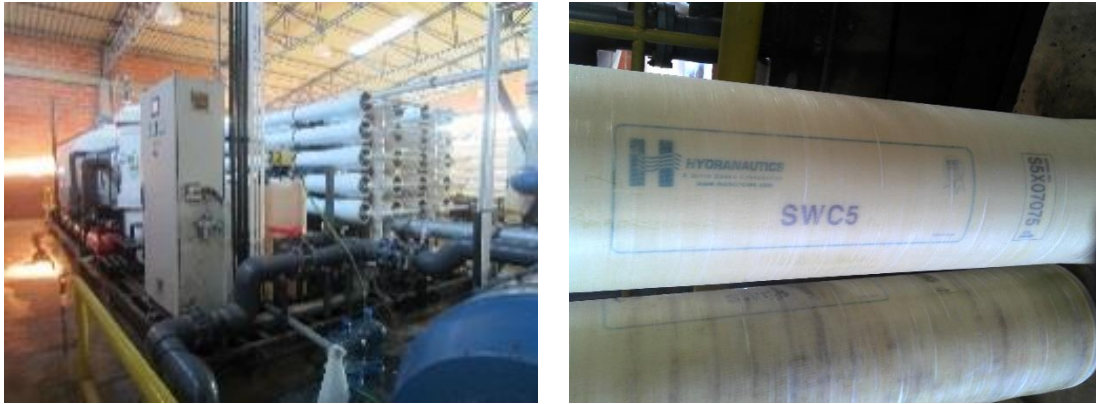
Foto 7-16 Foto Skid de osmosis inversa y membrana
