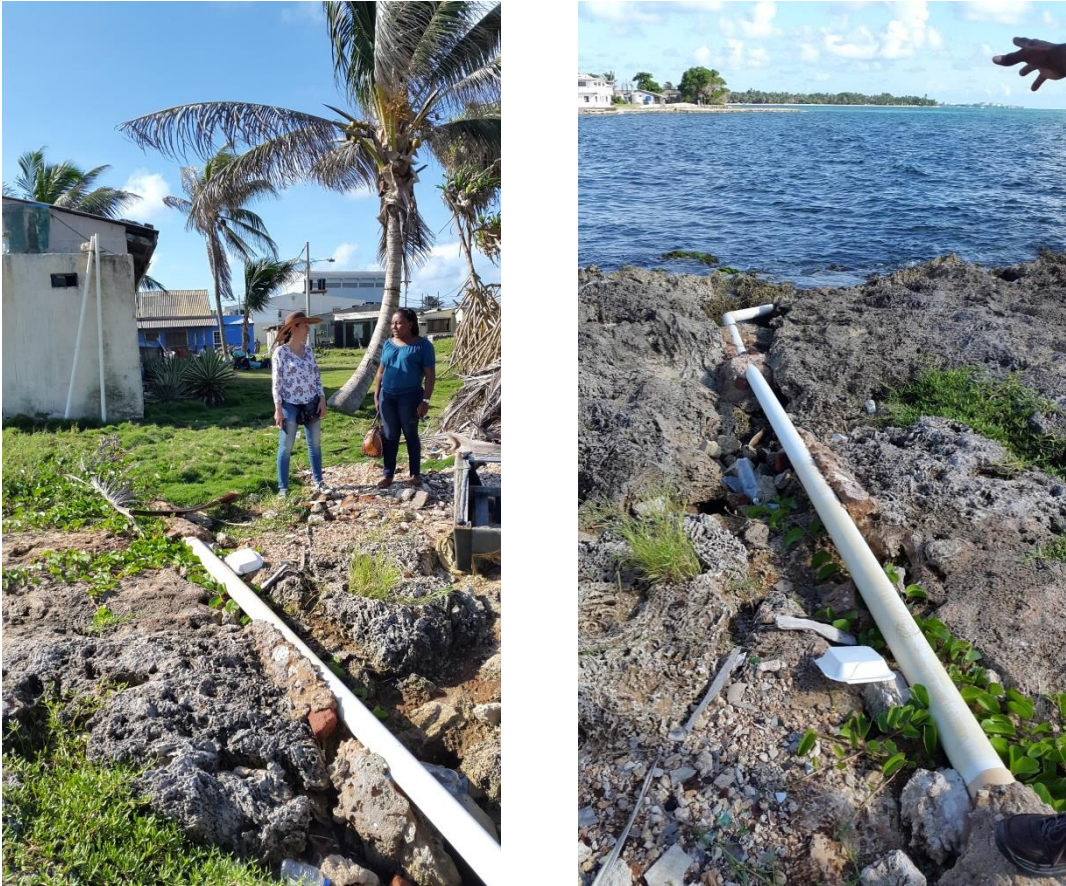
Foto 11-12. Conexiones erradas con vertimientos al mar.
