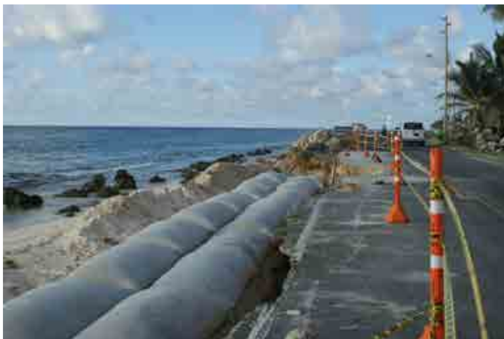
Erosión costera sector San Luis
